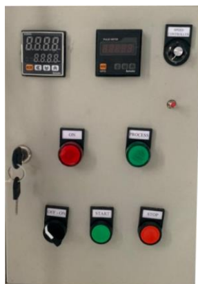
Gambar 5. Kotak Kontrol Panel
