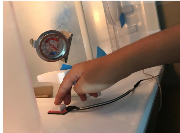
Gambar 3.2 Peletakan Sensor di Dalam Chiller
