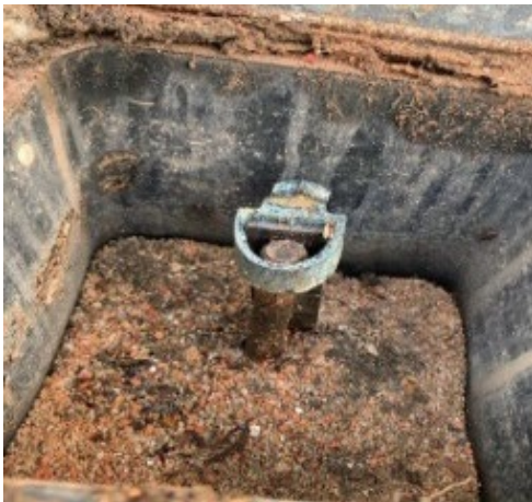
Gambar 3. 1. Kondisi Elektroda Pentanahan
