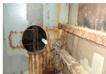
Gambar 9: Korosi pada Deep Tank
