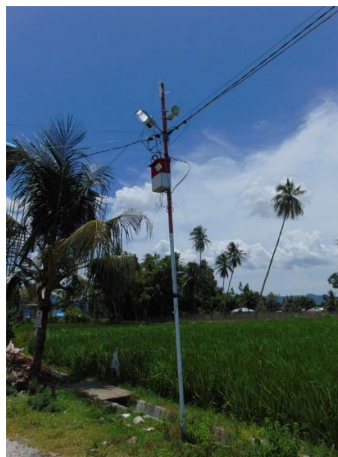
Gambar 1. Contoh penyediaan hotspot di salah satu desa Indonesia yang menggunakan sistem pengkabelan dan membutuhkan sumber daya listrik. Sumber:[1]
