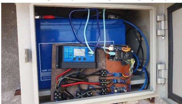
(b) Baterai dan sistem monitoring tenaga surya
