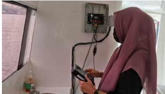
Gambar 3. Pengecekan Kelistrikan Kapal
