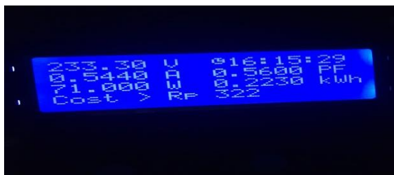
Gambar 13. Pengukuran Kwh Ruang Dosen Lab W7
